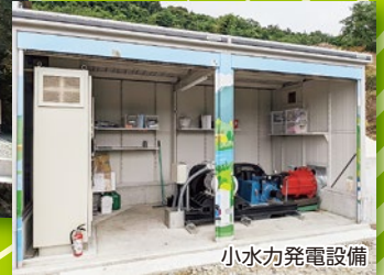
小水力発電所の建屋と導水管
